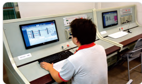
控制室及圖控系統
