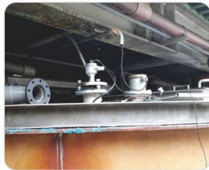
硫酸銅儲存槽
