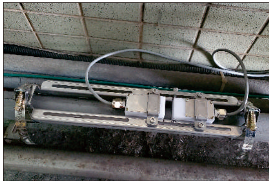
食品業-鍋爐純水管
