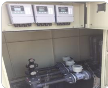
電鍍業-廢水排放系統
