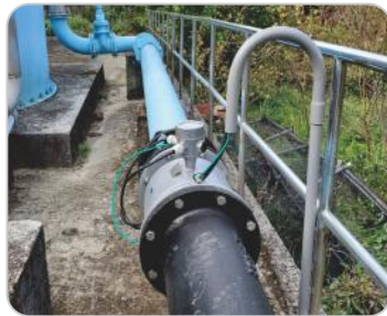
公家單位-淨水廠流量監控
