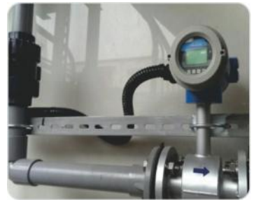
電子廠-製程廢水流量偵測
