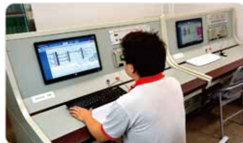
控制室及圖控系統
