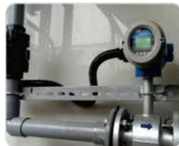
電子廠-製程廢水流量偵測
