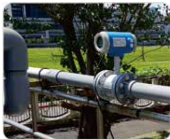
焚化爐-廢水排放流量偵測
